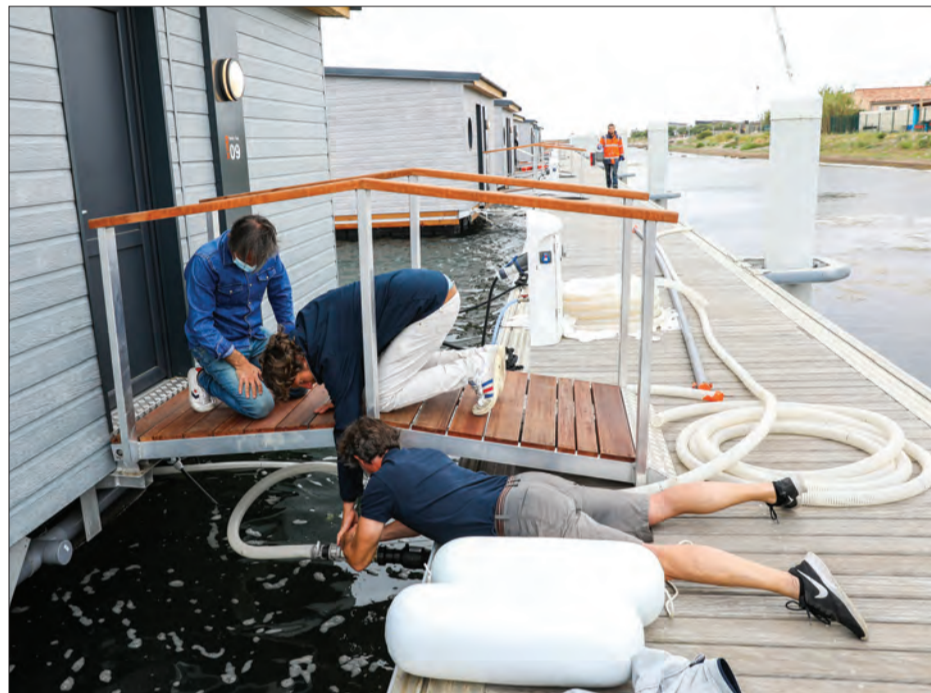
Chaque lodgeboat est homologué comme un bateau et irréprochable sur le plan environnemental : l'îlot est raccordé directement au ponton pour l'acheminement de l'eau, de l'électricité et l'évacuation des eaux usées avec des systèmes de pompes reliées au tout à l'égout. Des nurseries à poissons, appelées biohuts seront installées après la saison 2022 sous chaque lodge pour protéger la biodiversité sous-marine locale.
